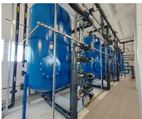
Fotografia 50: Stacja uzdatniania wody w Marianach po zakończeniu realizacji projektu
