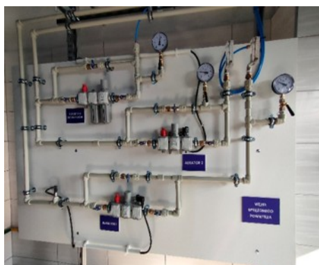
Fotografia 48: Stacja uzdatniania wody w Marianach po zakończeniu realizacji projektu
