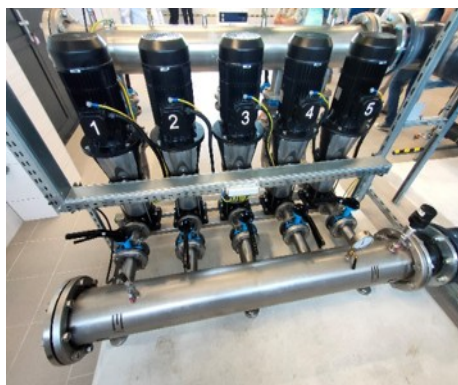
Fotografia 46: Stacja uzdatniania wody w Marianach po zakończeniu realizacji projektu
