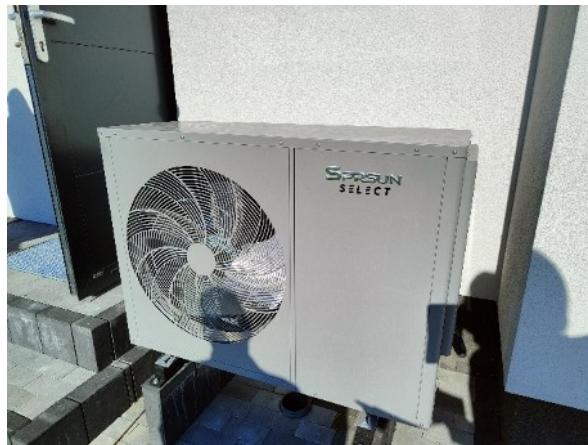
Fot. 28: Zamontowane urządzenia w ramach projektu Poprawa bezpieczeństwa energetycznego poprzez dywersyfikację źródeł energii na terenie gminy Kowalewo Pomorskie
