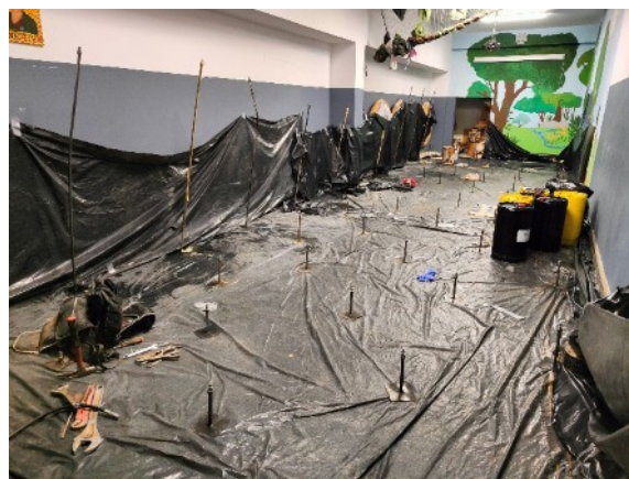
Fot. 10: Termomodernizacja hali sportowej i łącznika w zakresie ocieplenia dachu oraz wykonanie fundamentów wzmacniających w hali sportowej
