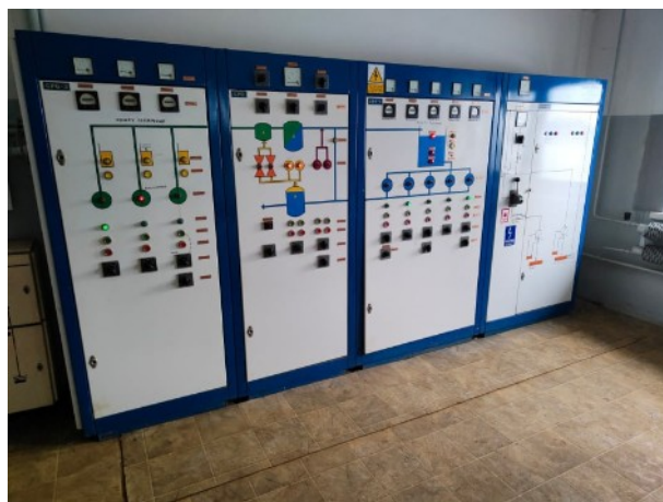
Fot. 20: Obecny stan wyposażenia Stacji Uzdatniania Wody w Piątkowie
