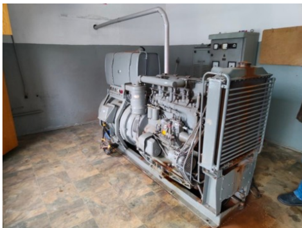
Fot. 19: Obecny stan wyposażenia Stacji Uzdatniania Wody w Piątkowie
